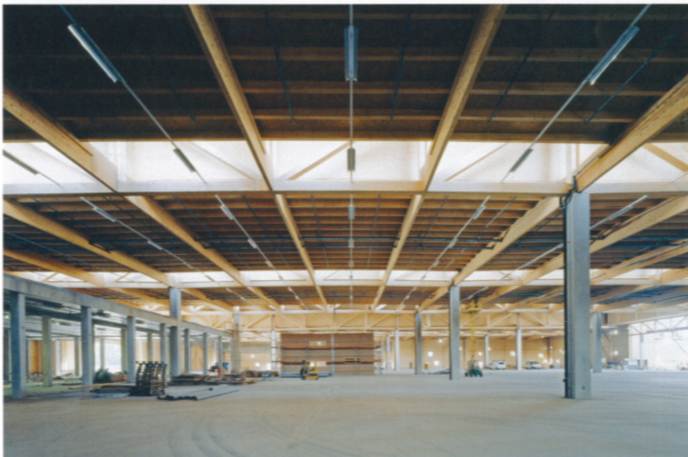
Die großen Stützenabstände im Inneren garantieren eine hohe Flexibilität in der Nutzung der Halle
